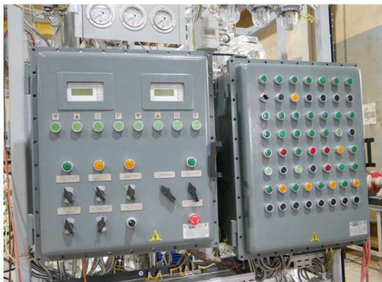
Слева направо: шкаф силовой и шкаф управления установки разогрева УРВП
