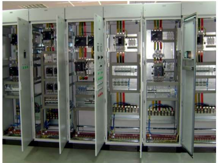
Фото 2. Шкафы централизованной системы автоматизации наливного терминала
