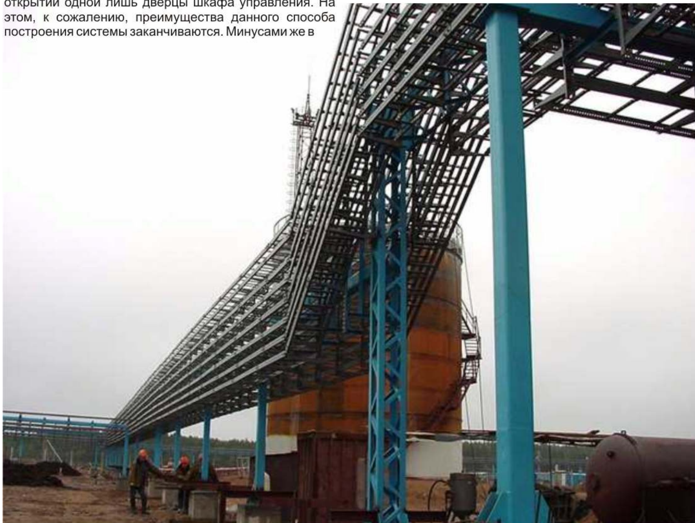
«Тонны меди». Кабельные трассы на нефтеналивном терминале.
